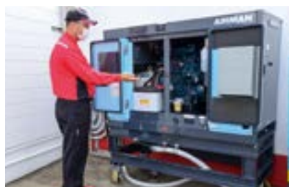
給油所に導入した緊急用発電機は災害時でも燃料を供給しライフラインを守る
