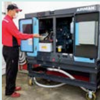
給油所に導入した緊急用発電機(美星給油所)
